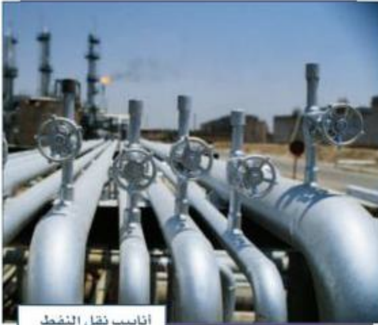
أنابيب نقل النفط
