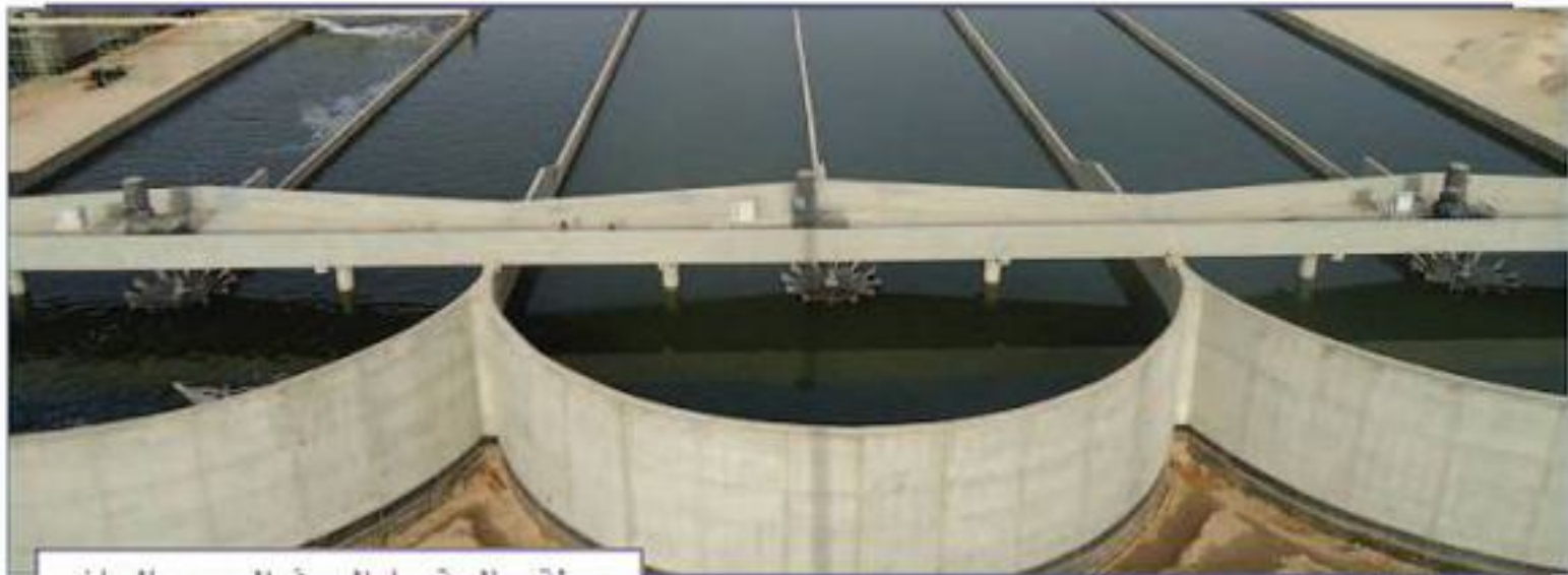
محطة معالجة مياه الصرف الصحي بالرياض
